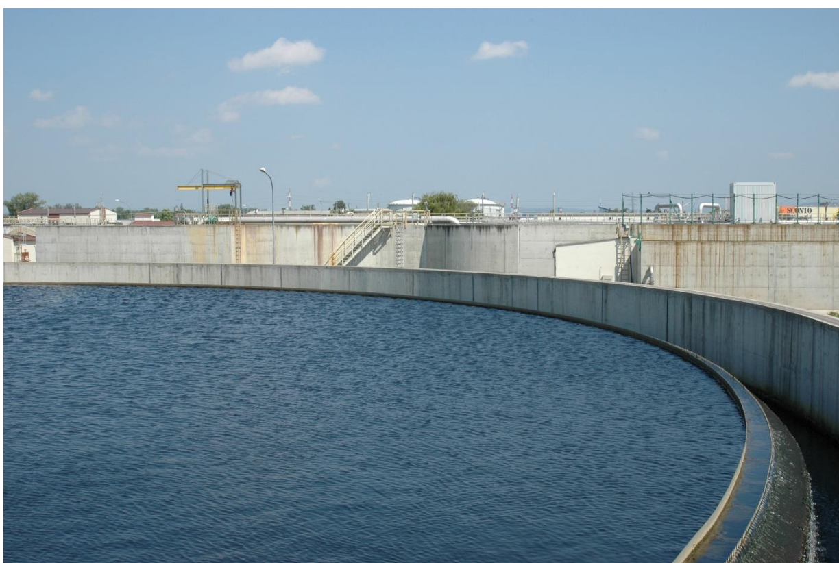
Obr. 13: ČOV Modřice, dozovací nádrž
