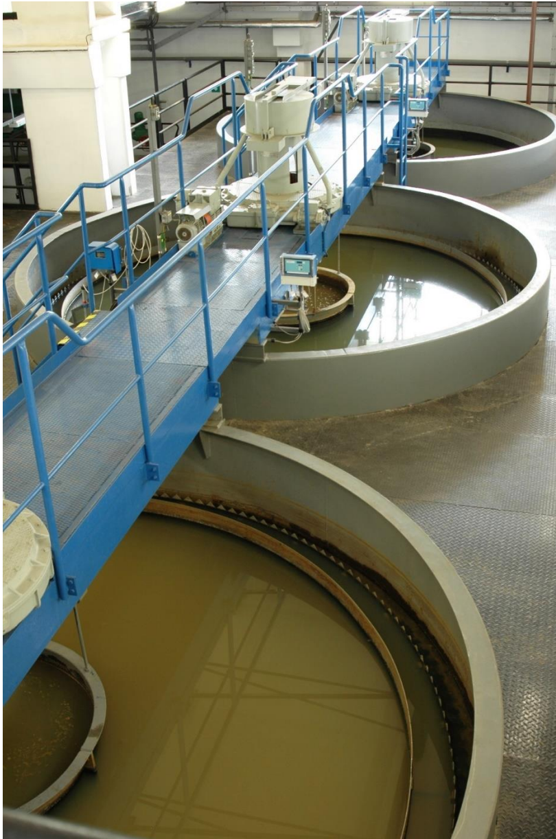
Obr. 20: Úprava vody Švařec, kalové nádrže
