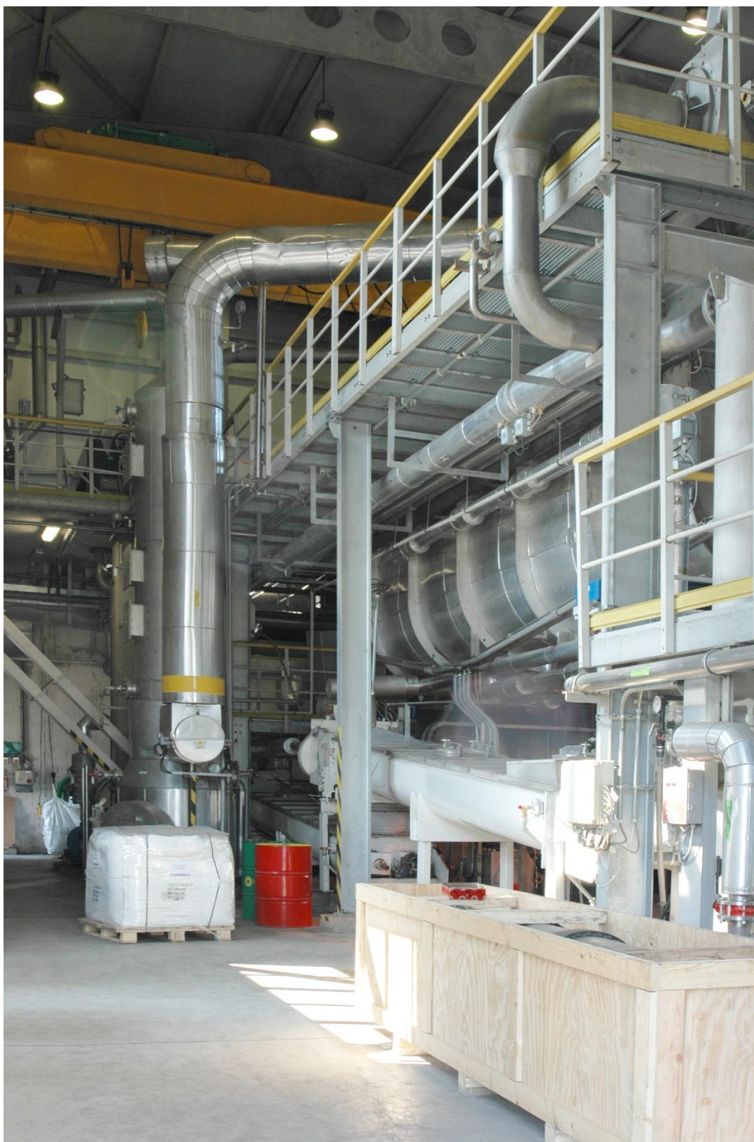
Obr. 14: ČOV Modřice, sušárna kalu
