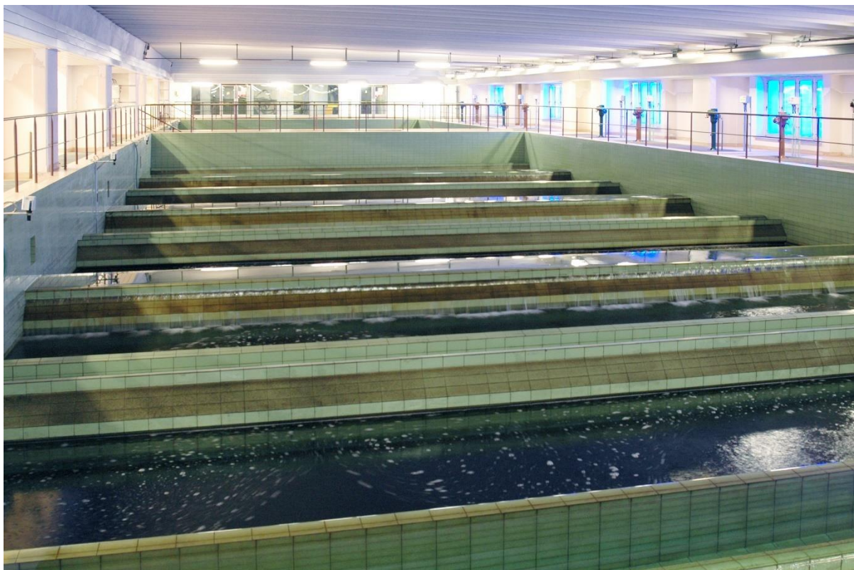
Obr. 19: Úpravna vody Švařec, hala filtrů Zdroj obrázku: Brněnské vodárny a kanalizace, a.s.
